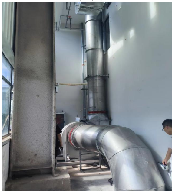
通风系统排气筒（筒内设烟雾报警探头）
