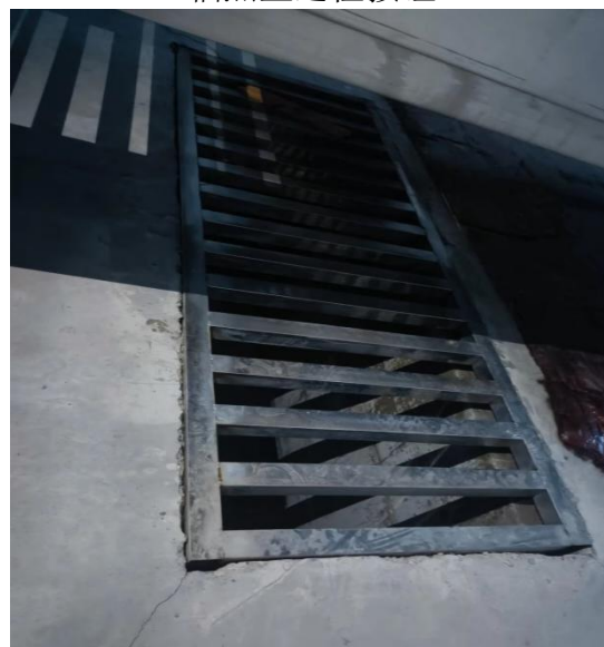
辐照室迷道内通风口
