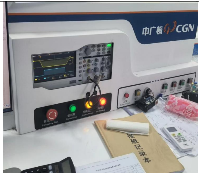
控制室钥匙、急停开关
