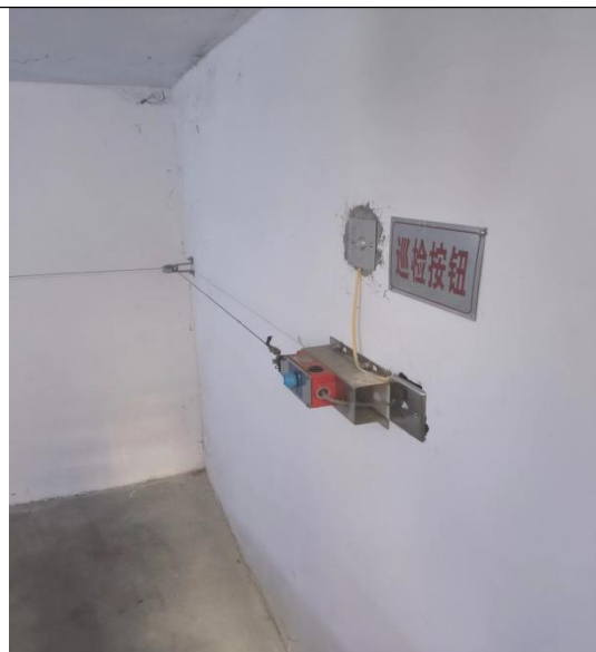
辐照室紧急开门按钮
