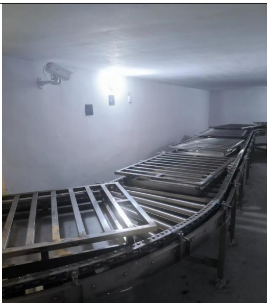
辐照室监控摄像头和应急照明
